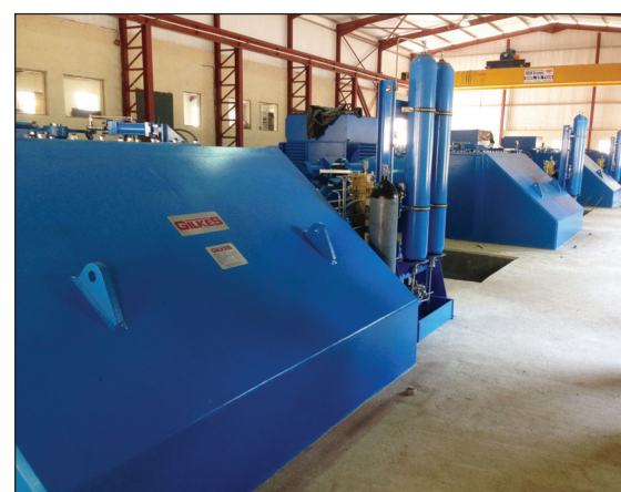
(d) Twin jet Turgo turbines at the Pungwe B powerhouse in Zimbabwe.
